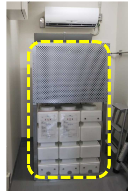
○ 非常用発電設備 （燃料電池）の整備
