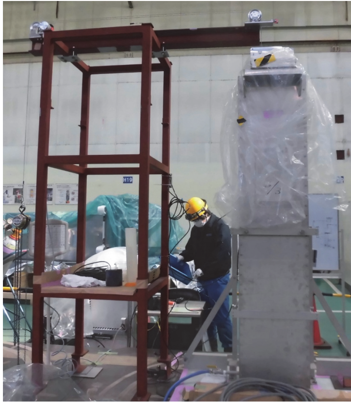
図 6.2.3.1-2 (2/6) モックアップ試験装置の全体写真 (背面)
