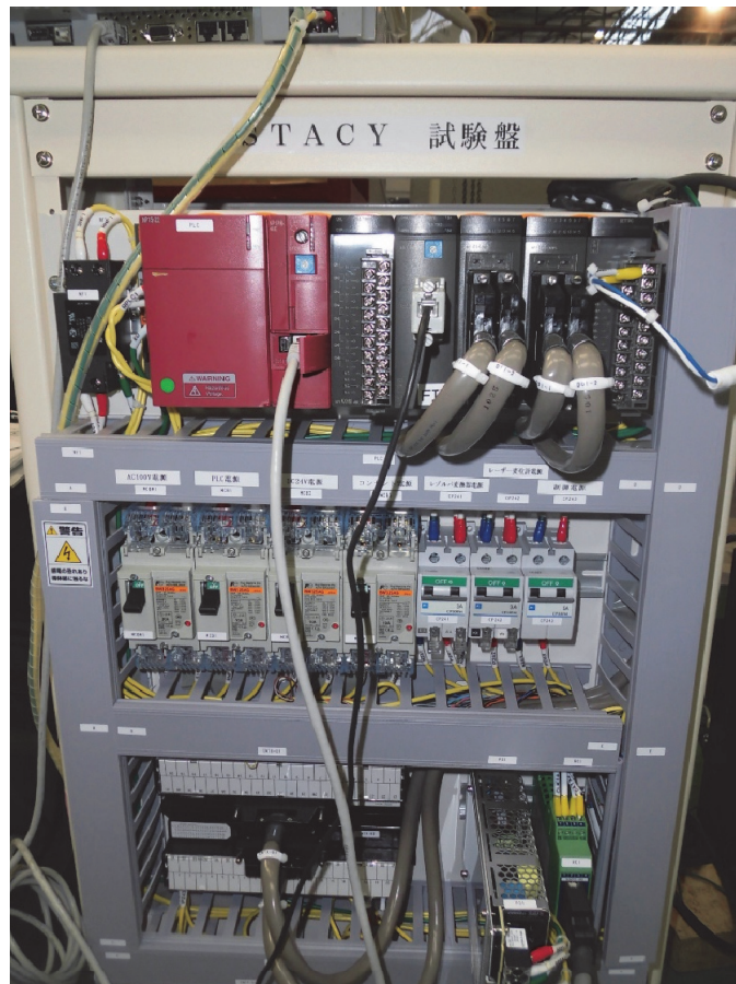
図 6.2.3.1-2 (6/6) モックアップ試験装置：試験盤
