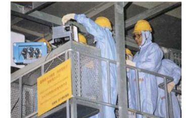
監視装置の保守管理
