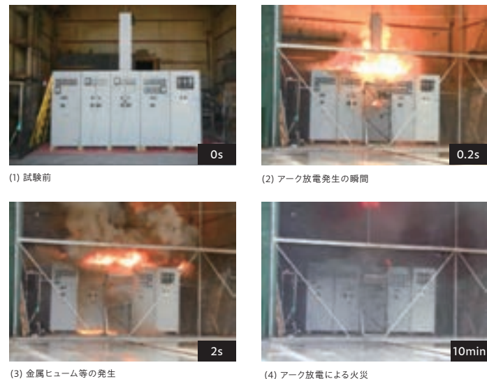
高圧電源盤の高エネルギーアーク損傷(HEAF)試験の様子
