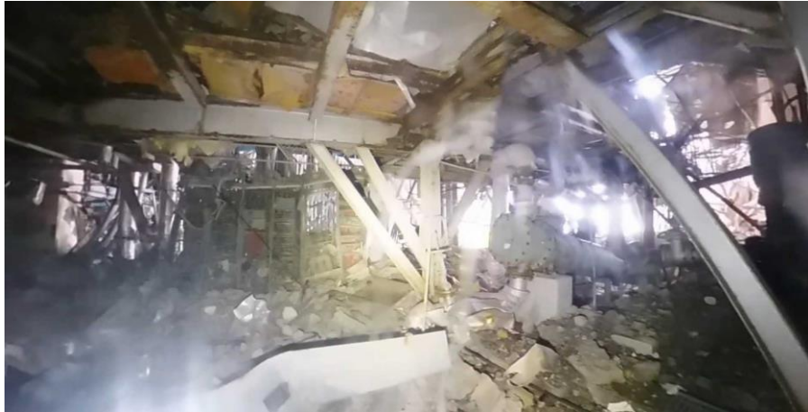
図4 4階に設置されている設備・ラックの状況（図1の写真②-2）
