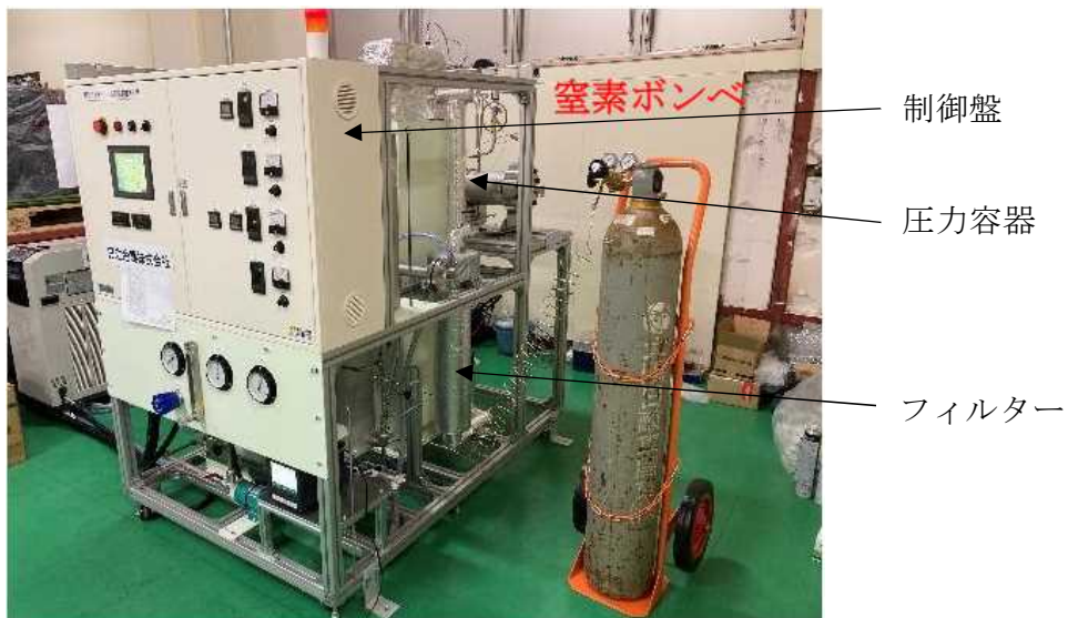
(a) 制御盤側
