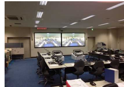
TV会議システム等通信設備
