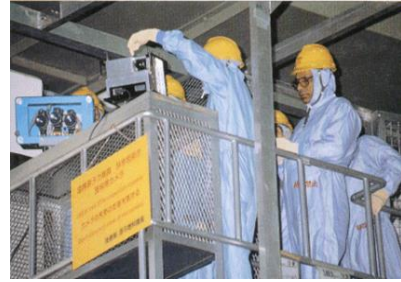
監視装置の保守管理
