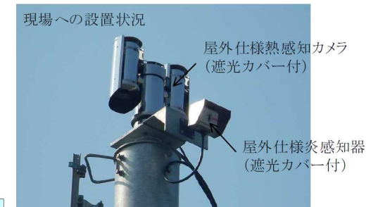
火災感知器の設置例
