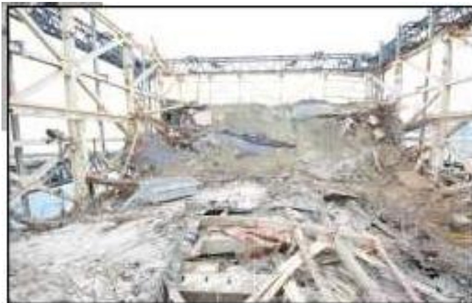
図6 1号機のおペフロの状況※
