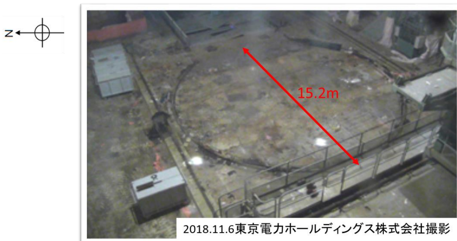
図5 2号機のおペフロの状況(2018年11月6日)
