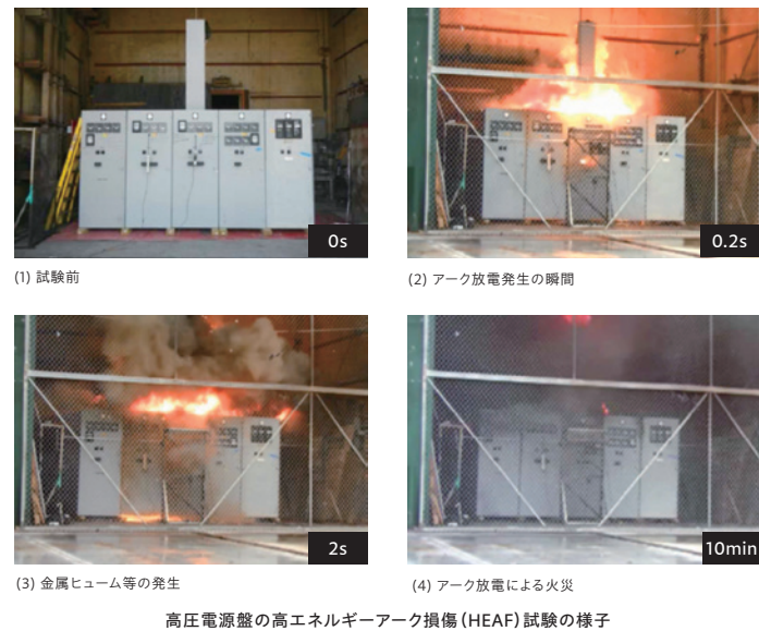
高圧電源盤の高エネルギーアーク損傷(HEAF)試験の様子
