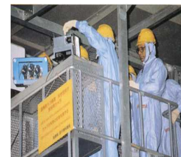
監視装置の保守管理
