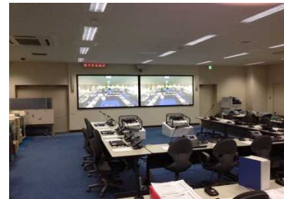
TV会議システム等通信設備
