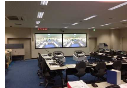
TV会議システム等通信設備
