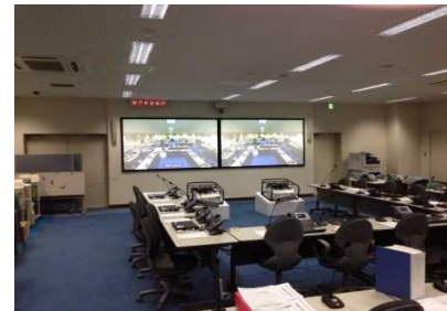
TV会議システム等通信設備
