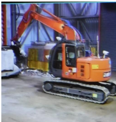
【写真1】現場 重機 状況（粉碎したコンクリートを収納するコンテナの移動）
