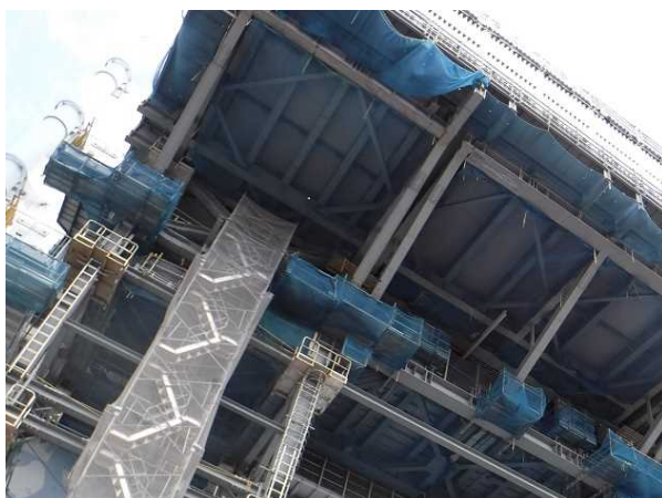
【写真1】前室下部
