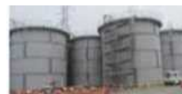
汚染水タンク (2)
