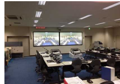
TV会議システム等通信設備
