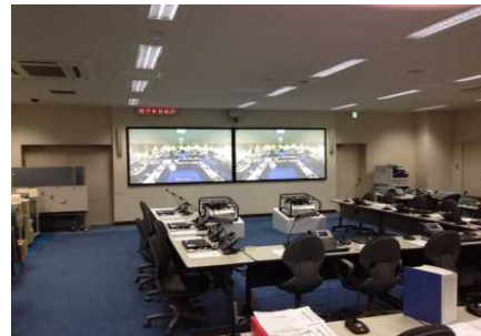
TV会議システム等通信設備
