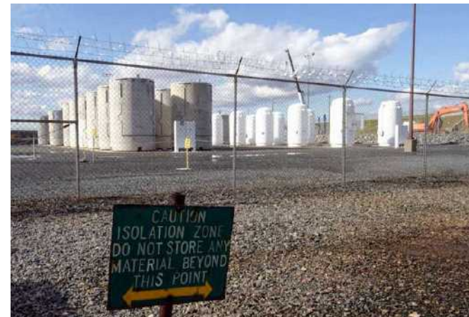
使用済燃料貯蔵施設の例(米国McGuire発電所)
