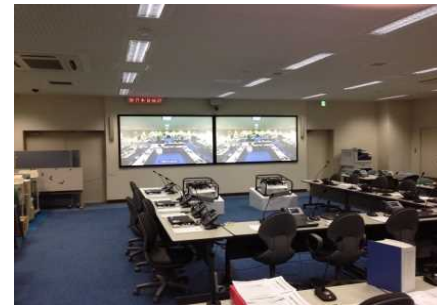
TV会議システム等通信設備
