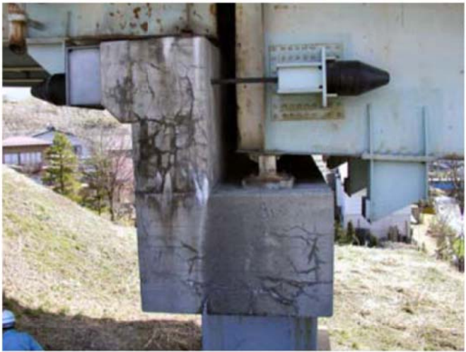
実構造物における膨張ひび割れの事例 (出典:アルカリ骨材反応による劣化を受けた道路橋の橋脚・橋台躯体に関する補修・補強ガイドライン(案) 平成20年3月 ASRIに関する対策検討委員会)
