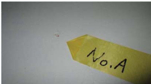
フロー②と判断した塗膜の劣化
