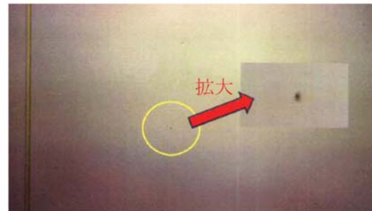
フロー③と判断した塗膜の劣化
