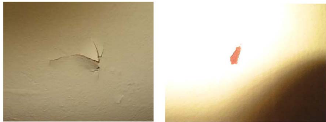
(例) 中塗り又は下塗りが見えている塗膜状況
