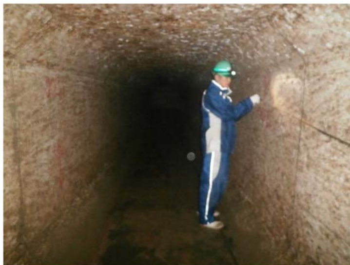
非常用海水路(1号炉)
