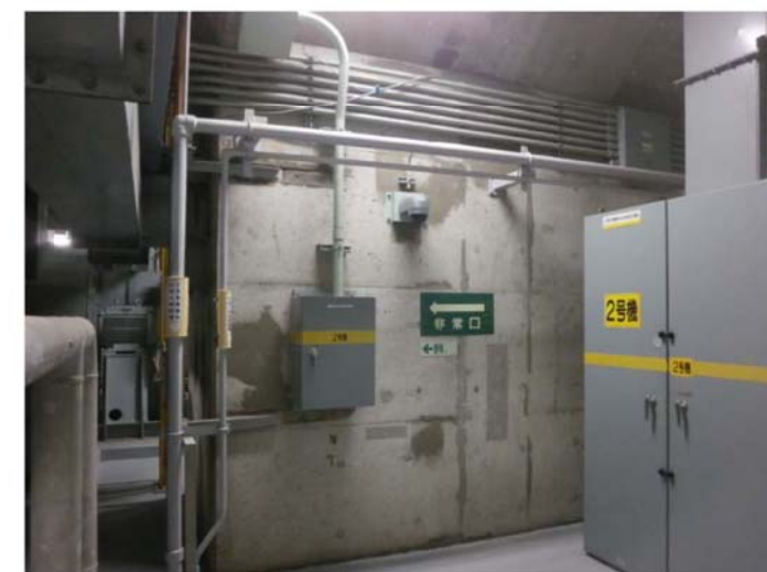
タービン架台(2号炉)
