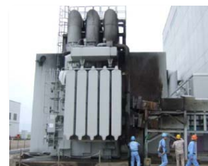
鎮火後の3号機所内変圧器 (東京電力提供)
