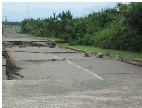
柏崎刈羽原子力発電所構内道路の地震後の状況 (東京電力提供)
