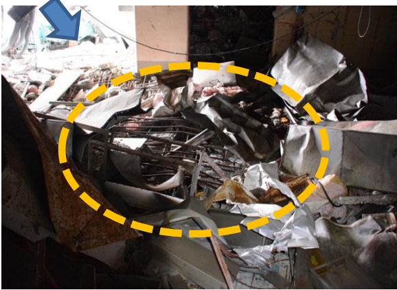
平成 25 年 7 月 12 日原子力規制庁撮影 3 階北西部 床面の損傷
