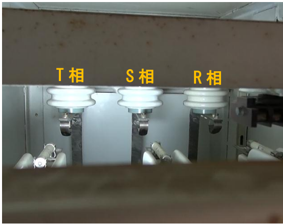
盤番号 5 の上部 絶縁抵抗測定箇所
