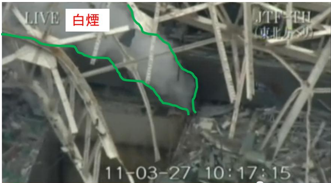
図6. 4 3号機原子炉建屋からの白煙の発生場所2 (出典：防衛省(平成23年3月27日撮影・同日公表)撮影ビデオより原子力規制庁が抜粋)
