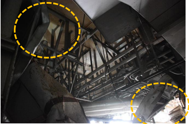
平成 25 年 7 月 12 日原子力規制庁撮影 3 階北西部 天井の損傷（ダクトの損傷）
