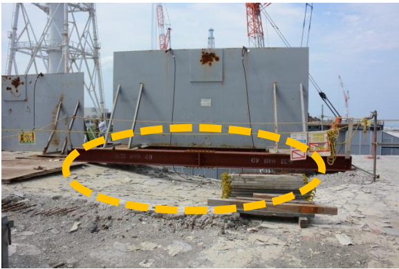
平成25年7月11日原子力規制庁撮影 5階北側床 下方への変形
