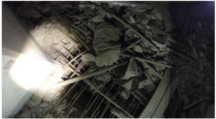
近接撮影（床面） 平成 26 年 2 月 6 日原子力規制庁撮影
