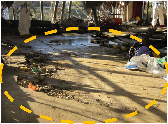
平成 23 年 11 月 8 日東京電力撮影 4 階南西部 床面の損傷
