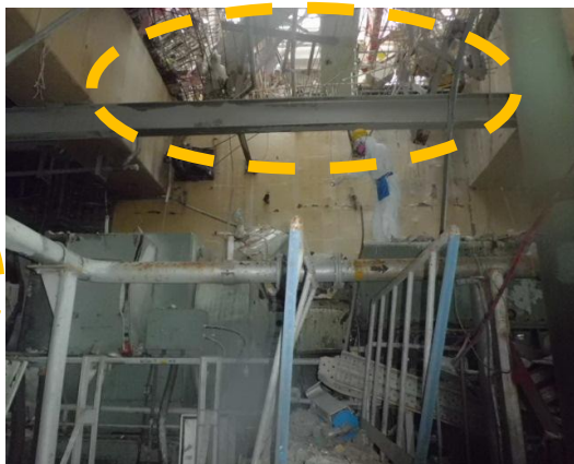
平成 23 年 11 月 8 日東京電力撮影 4 階南西部 天井の損傷
