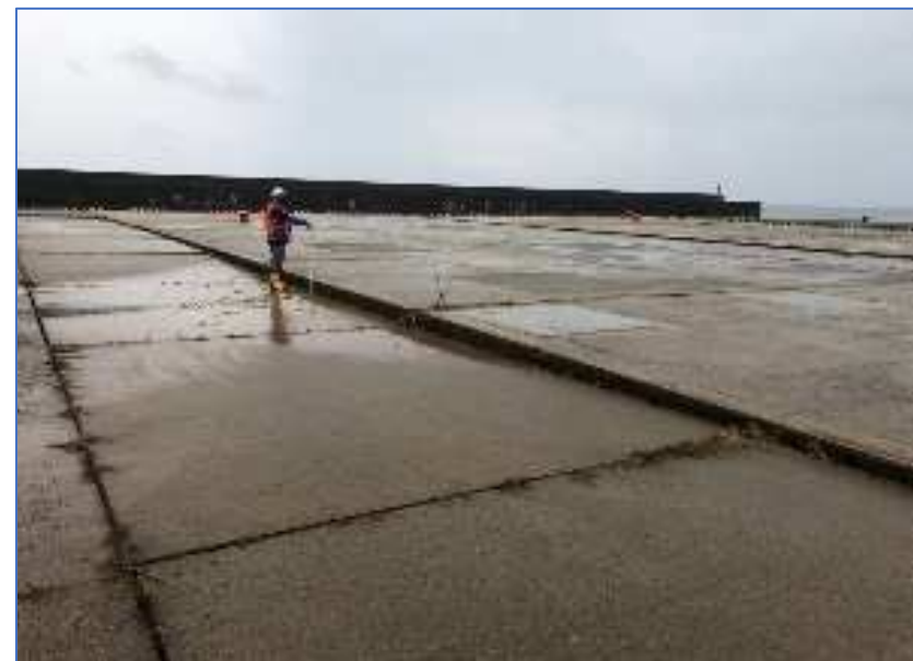
物揚場コンクリート舗装部の段差
