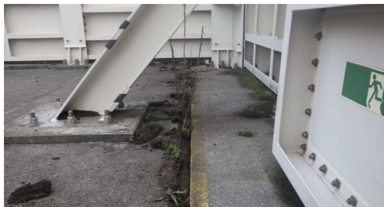
1号機防潮壁の基礎地盤の空隙
