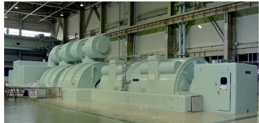
タービン発電機
