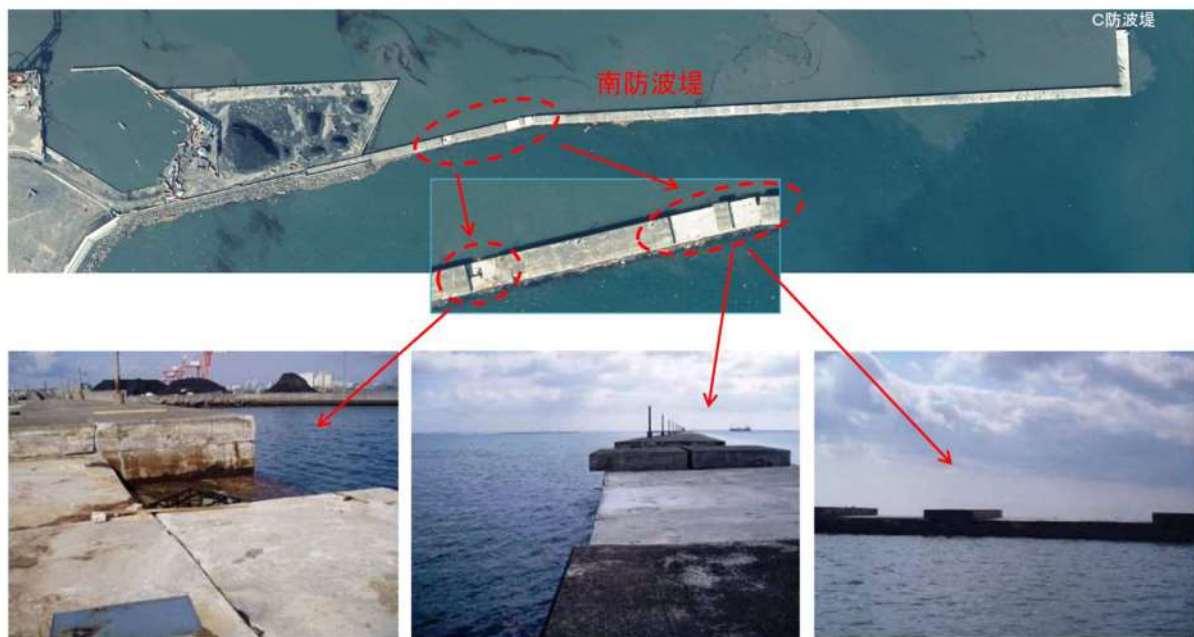
外港地区 南防波堤 (平成 23 年 3 月 23 日撮影 5) ) 上部工 欠落
