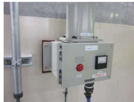
機器の固定状況
