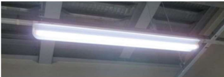
無停電運転保安灯
