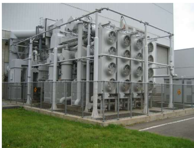
第1図 変圧器外観
