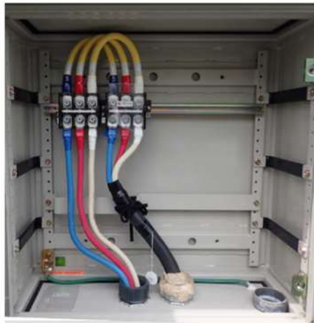
ボルト・ネジ接続 (代替直流電源)
