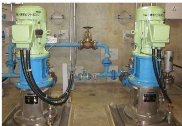
添付 7-5 図 湧水ピットポンプ写真
