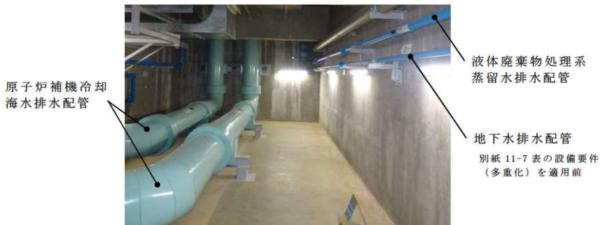
添付 7-6 図 地下水排水配管写真（電気建屋）
