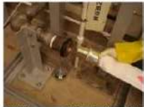
⑤ 可搬型ホース～使用済燃料ピット補給用冷却配管 接続前
