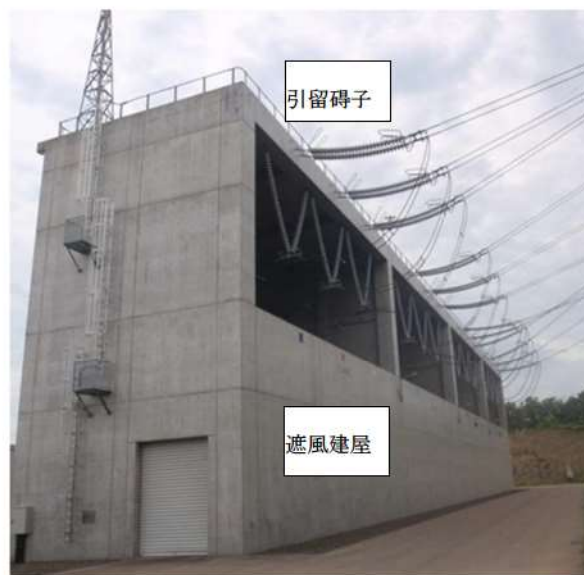
第 5.1 図 275kV 架線部 (引留碍子)
