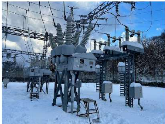
国富変電所（GCB）
