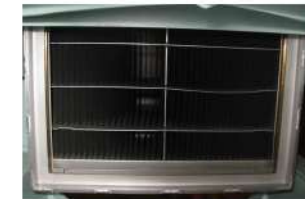
装置底部 (PAR入口給気口)
