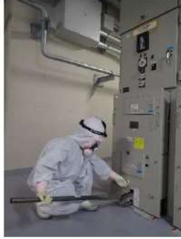
受電遮断器操作 (安全補機開閉器室) (原子炉補助建屋T. P. 10. 3m)
