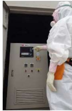
代替非常用発電機起動 (屋外)
