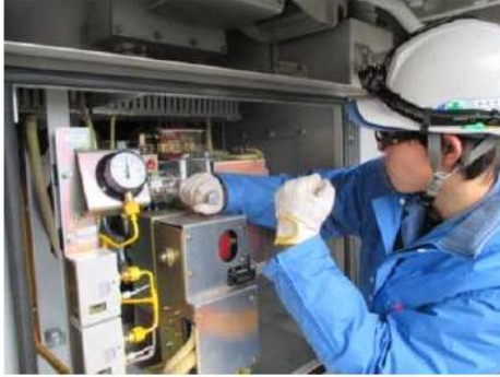
開閉所設備遮断器操作 (屋外)
