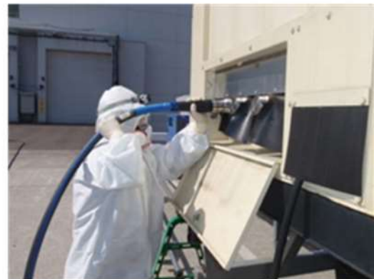
高圧ケーブル接続 (コネクタ) (屋外)
