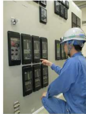
保護リレーロック操作 (1号炉2次系継電器室) (原子炉補助建屋T.P. 9.8m)
