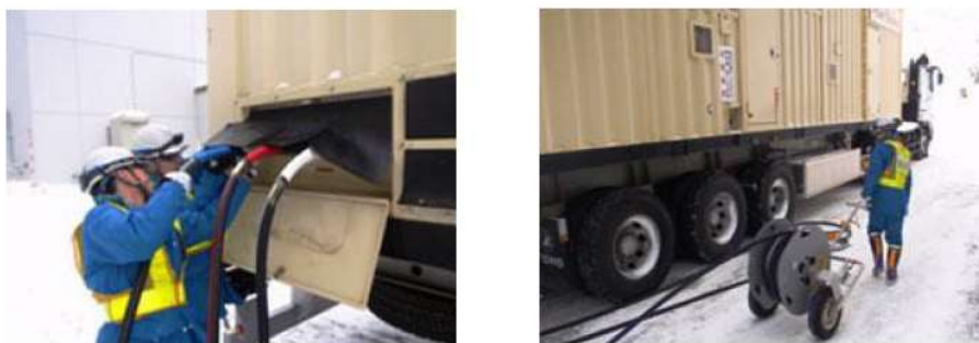
図2 可搬型代替電源車設置訓練
