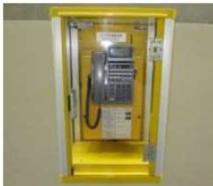
運転指令設備（警報装置を含む）
