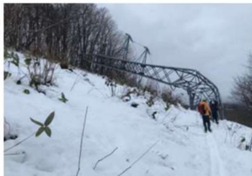
大雪による鉄塔倒壊事例 ※3
