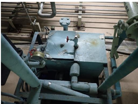
No. 15 セル冷却水循環装置
