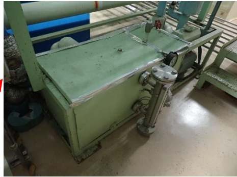
No. 18 セル冷却水循環装置
