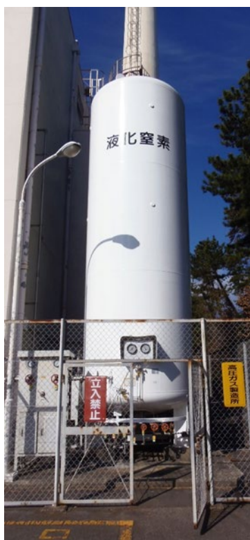
図 1 窒素ガス供給設備
