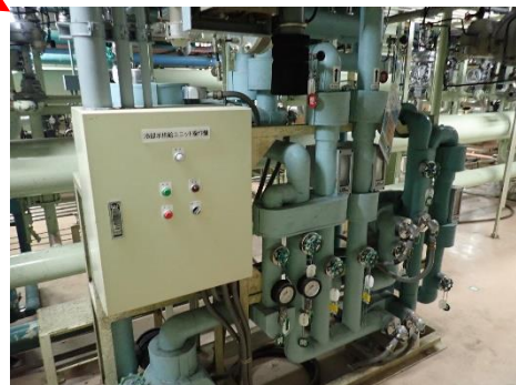
No. 14 セル冷却水循環装置
