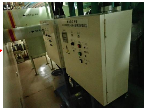
No. 16 セル冷却水循環装置
