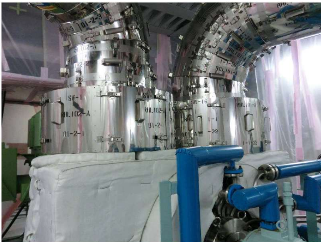
余熱除去ポンプ 配管周辺部
