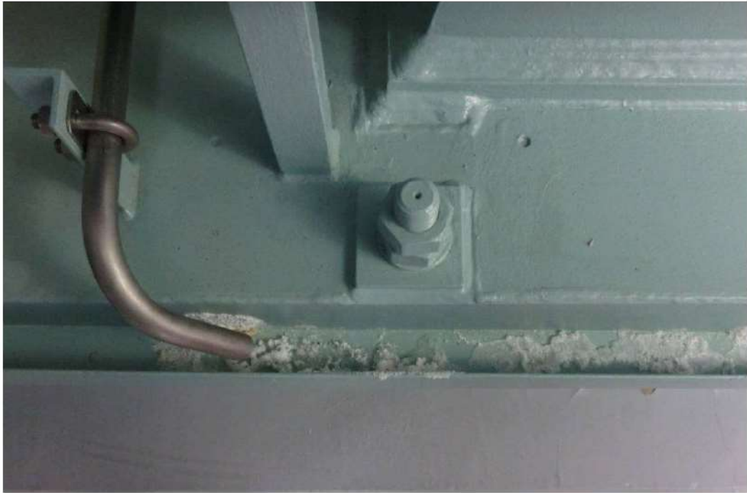
余熱除去ポンプ 据付部
