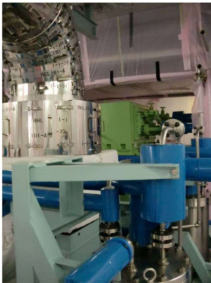
余熱除去ポンプ 外観
