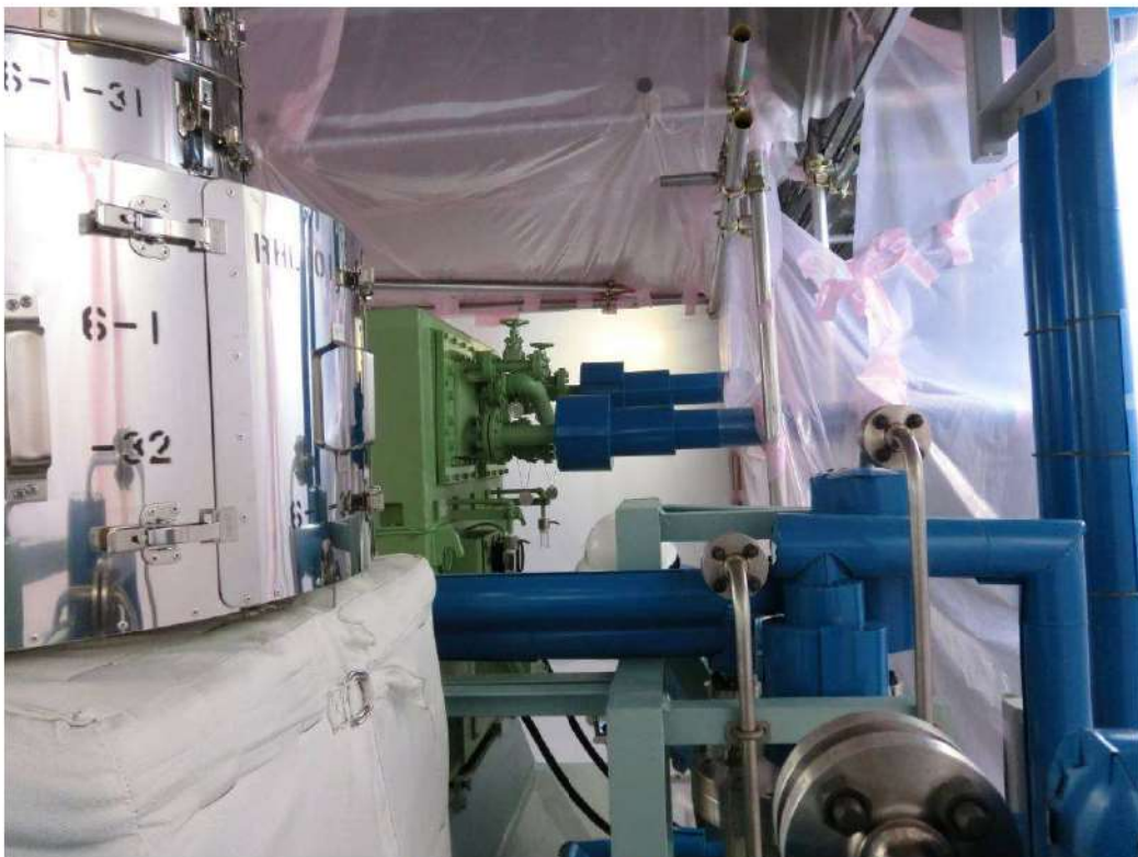
余熱除去ポンプ 周辺状況
