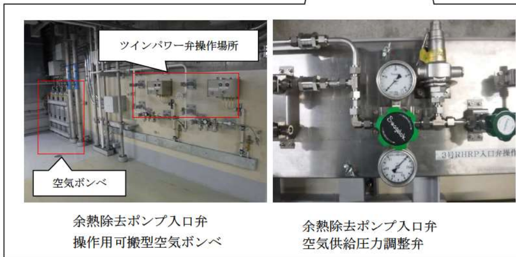
図3 ツインパワー弁操作場所及び余熱除去ポンプ入口弁操作作用可搬型空気ボンベ
