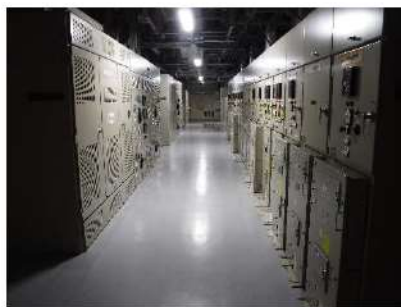
【図1 3B-安全補機開閉器室】
