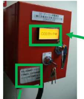
写真③ 放出ロック盤
