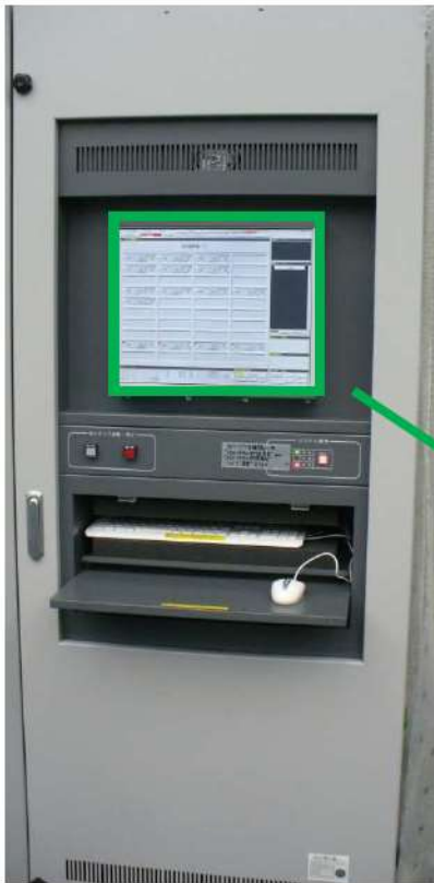
写真④ 中央制御室 総合操作盤
