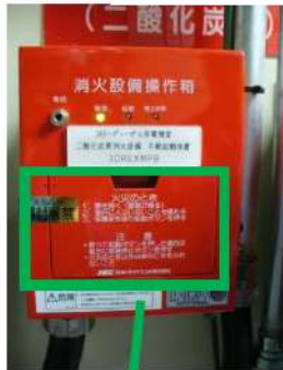
写真⑤ 消火設備操作箱
