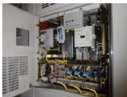
パワーコントロールセンタ
