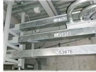
ケーブルトレイ，電線管の例
