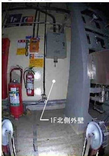
①1F北側外壁
