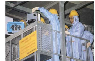
監視装置の保守管理
