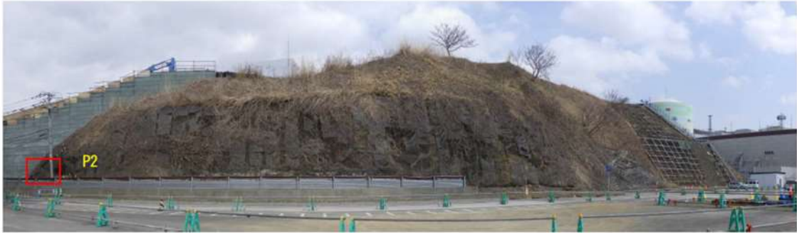
図 2.1.a.c-4 (1) 防潮堤（茶津側）露頭状況 P1 防潮堤擦り付け部全景 擦り付け部は海食崖に位置し，凝灰角礫岩及び凝灰岩 （砂質凝灰岩）が分布する。
