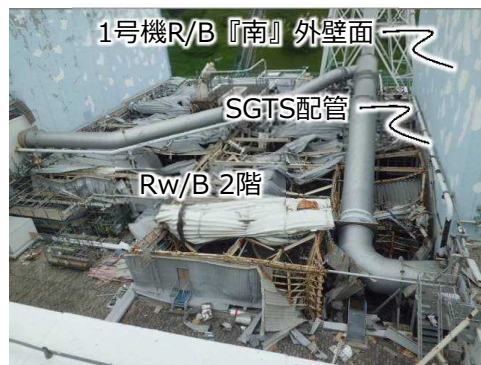
震災後の状況
