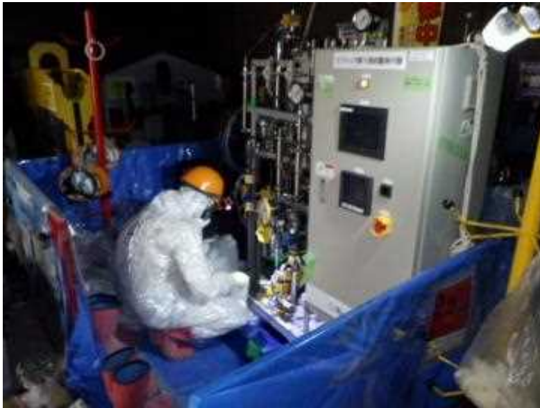
フィルタ通水試験装置写真
